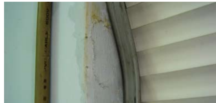
注意牆角、窗框的牆面，是否有水漬
